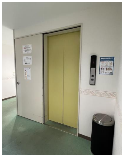
▽エレベーター
