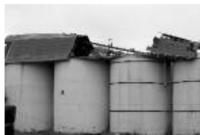
屋根が壊れたサイロ
