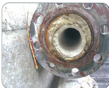
配管に付着したスケール（湯花）
