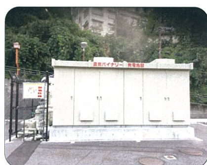
福祉避難所での自立型発電設備
