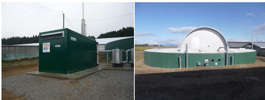
図 3-1 7 八雲町家畜糞尿バイオガス発電（右：発電機、左発酵槽）
