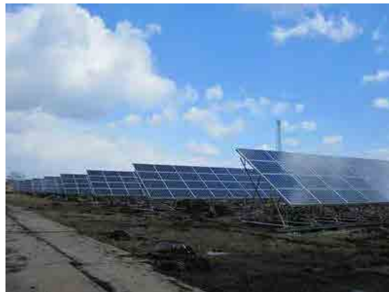
写真 1-9 郵船商事の太陽光発電システム
