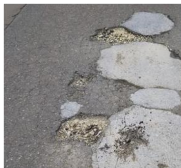
ポットホールの増加による タイヤのパンク、車の破損
